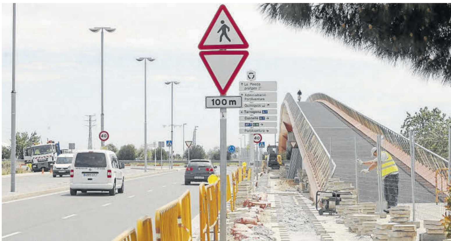
Imagen de los trabajos que estos días se han hecho en el puente elevado del Raval de la Mar, en la rotonda del cruce con la A-7. FOTO: ALBA MARINÉ
